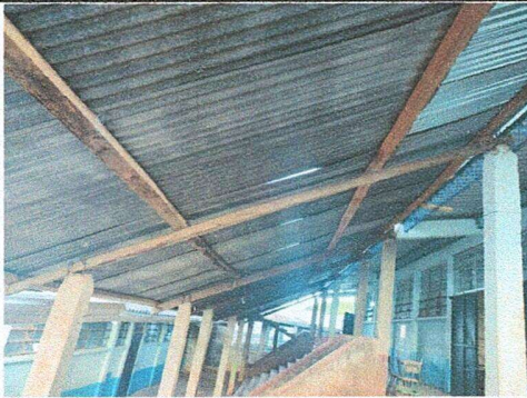
Foto 3: TRIBUNA ESCOLAR CAMBIO DE CUBIERTA DE LAMINA Y VIGAS DE MADERA A METAL.
